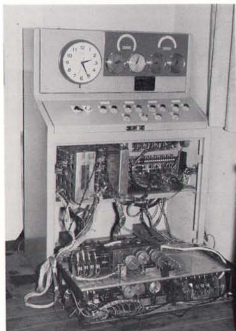
アンテナ制御盤。1日のアンテナの動きは自動的に制御される。
