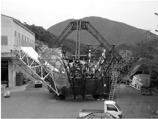
図1 VERAの20m電波望遠鏡の鏡面の工場仮組の様子。私がVERAに参加した当時はアンテナの建設前であり、文字通り0からのスタートでした。
