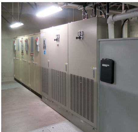
図7 新設された無停電電源装置(UPS)
