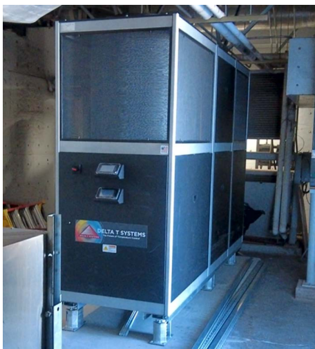
図8 新設されたチラー(冷媒循環装置)
