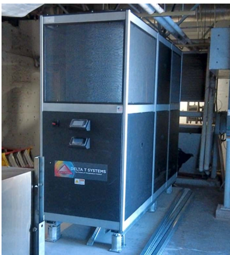
図8 新設されたチラー(冷媒循環装置)
